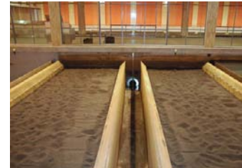
Filterbecken außer Betrieb
