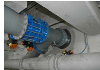
Rohrleitungen am Zu- bzw. Ablauf
