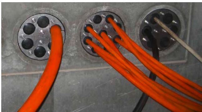
HRD 150-SG eingebaut in Faserzementfutterrohre
